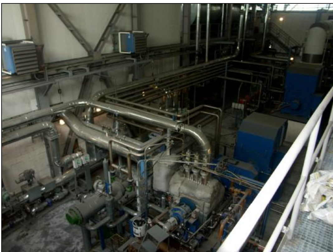
Obr. 23 Pohľad do strojovne kotolne pre spaľovanie biomasy
