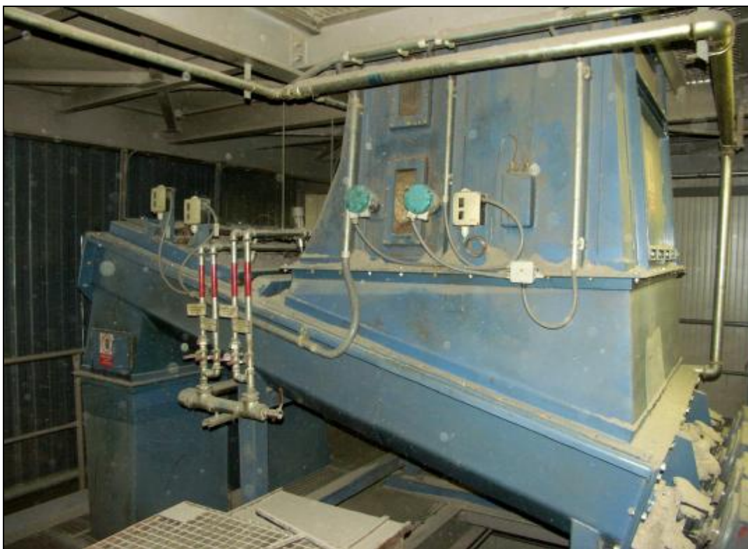
Obr. 22 Priebežný zásobník biomasy a skrutkovité dopravníky pred horákom kotla
