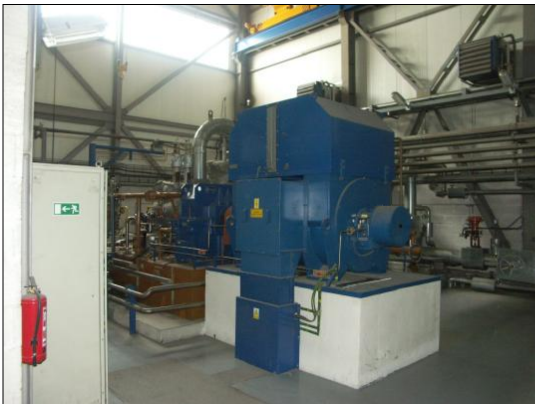
Obr. 24 Protitlaková turbína s elektrickým generátorom 1,54 MW e
