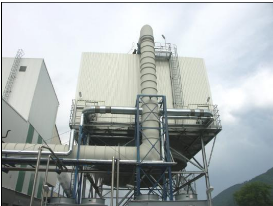
Obr. 26 Vzduchový kondenzátor pre kondenzačnú turbínu
