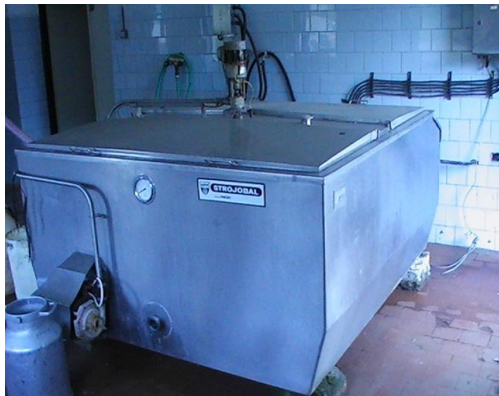
Obr. 7 Nádrž na mlieko Paco (2500 l) Bukovce
