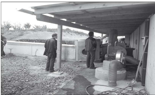
Obr. 17 Prevzdušňovacie ventilátory a biofilter na čistenie odsávaného vzduchu zo základok (Galovič, 2007)
