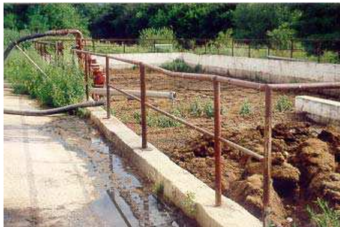
Obr. 3 Podzemná skladovacia nádrž na hnojovicu
