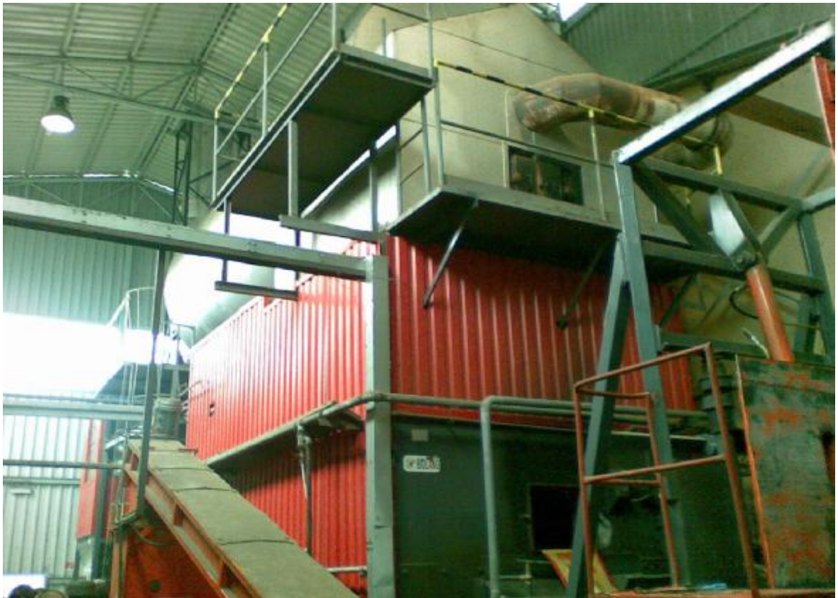
Obr.20 Kotel na spaľovanie slamy s výkonom 4,5 MW v AgroDivízia Selice s.r.o.
