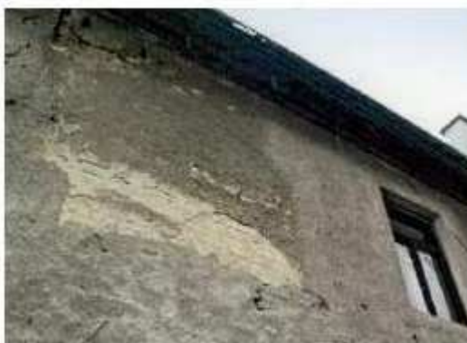
Obr.4 Vlhkosť následkom stavebných porúch
