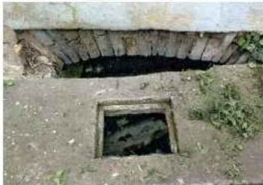
Obr.2 Vlhkosť spôsobená spodnou vodou
