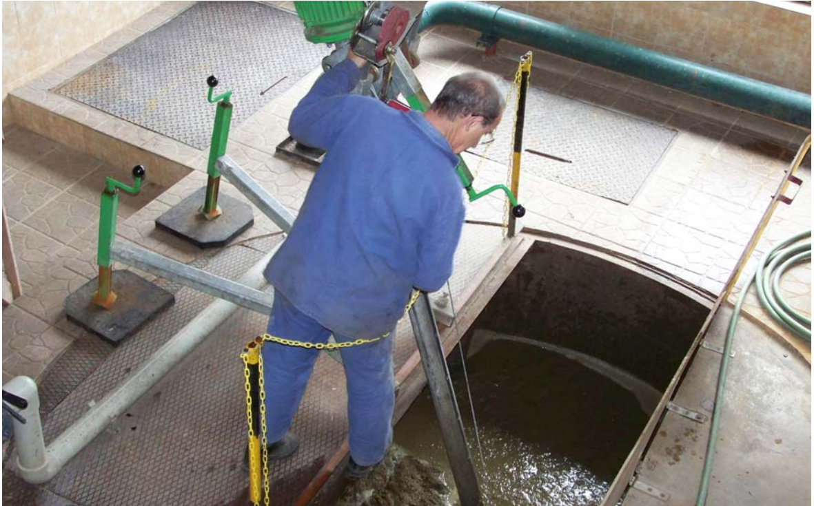
Obr. 10 Homogenizačná nádrž a miešadlo
