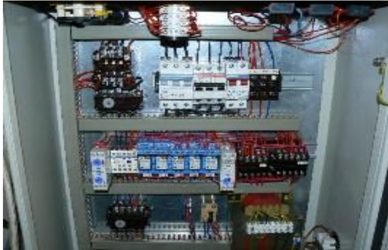
Obr.14: Elektrický rozvádzač lisu
