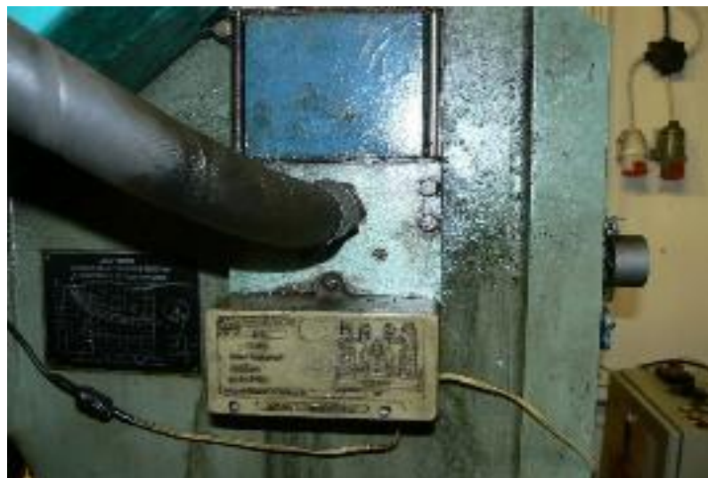
Obr.13: Prívod stlačeného vzduchu
