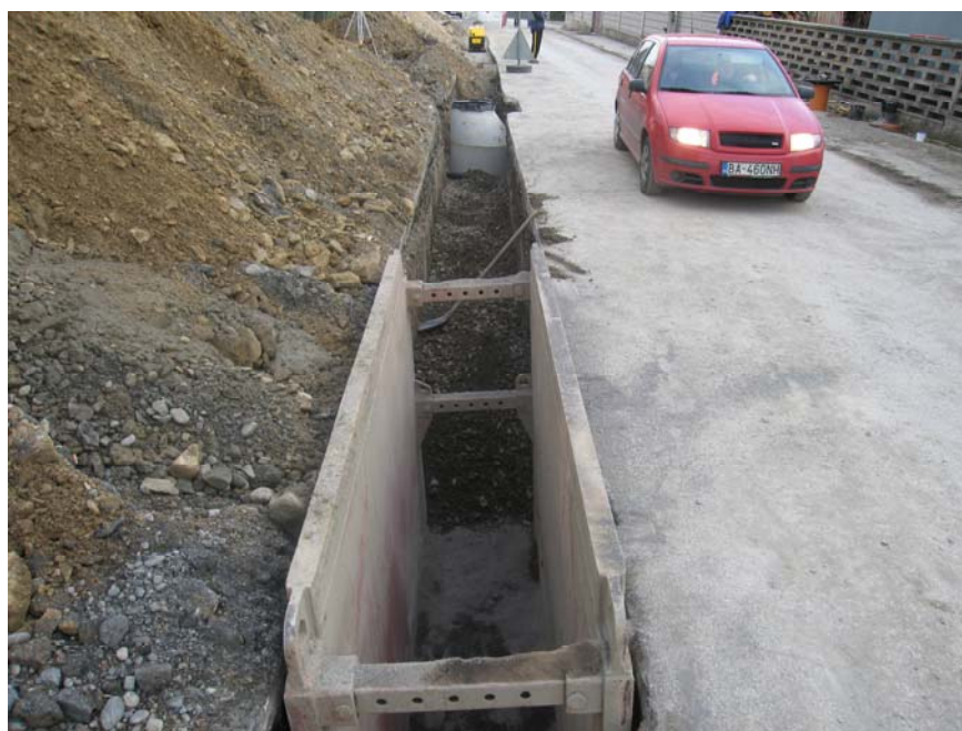
Obr. 9.4 Zásyp ryhy a úprava terénu
