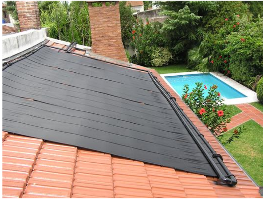
Obrázok 6 Plastové absorbéry na ohrev bazénovej vody
