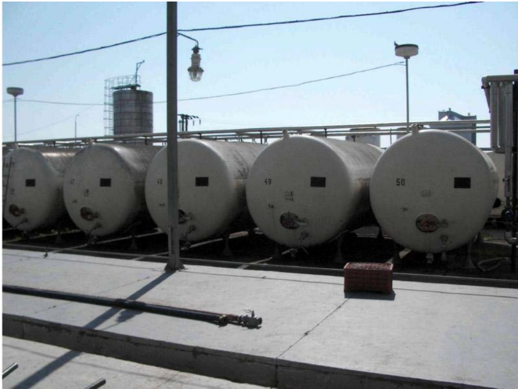
Obrázok 3 G: Pohľad na nádrže na odkalenie muštu
