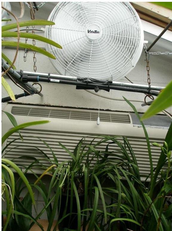
Príloha 5: Ventilátor na premiešanie vzduchu v skleníku
