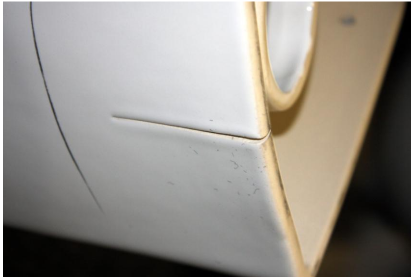
Obrázok č. 1 Prasklina na kombinačnej mise so spodným odpadom
