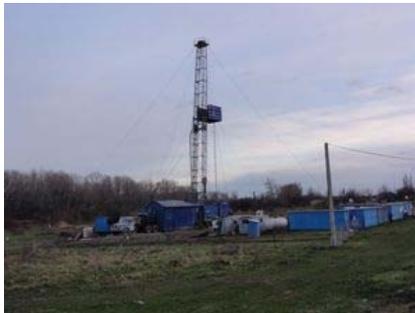
Obr. č. 5: Geotermálny vrt
